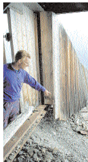
Bei der Garage: Permafrostboden sackt ab. BILDER: FRANZISKA SCHEIDEGGER
